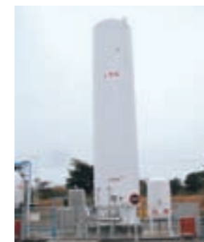
Exclusive LNG tank
